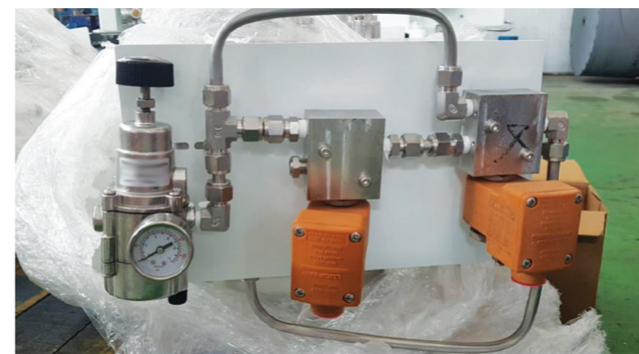
Eksempel på et uoriginalt kontrollpanel som ikke fungerte, og hvor kunden istedet bestilte nye Ellingsen kompaktpaneler.
